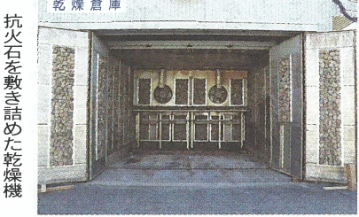
乾燥倉庫 防火石を敷き詰めた乾燥機
